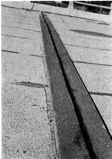
写真一4 川越街道をまたぐ立体交差点に 使用されたエキスパンション ジョイント
