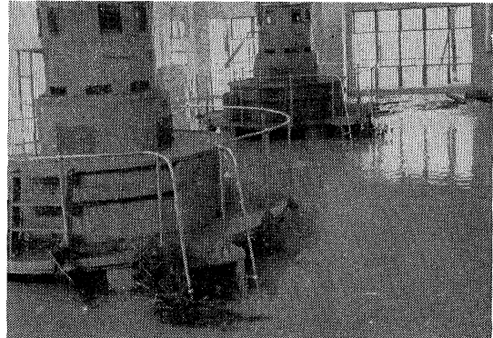
冠水した中島発電所発電機室
