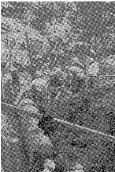
写真-1 青山浄水場被害状況(上)と青山～関屋間送水管仮布設工事状況
