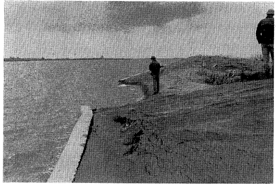
写真一六 堤外に発生した噴泥
