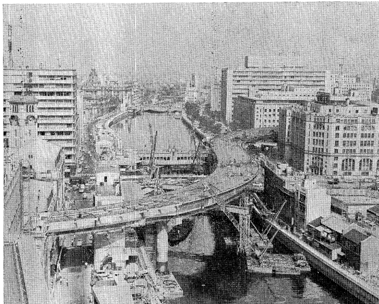
写真-1 大阪 1 号線土佐堀川 S 字橋付近
