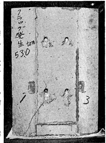
写真-1 供試体のスタットのせん断破壊
