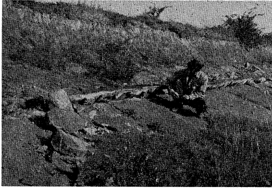
写真-3 太田堤防(南方村)の被害
