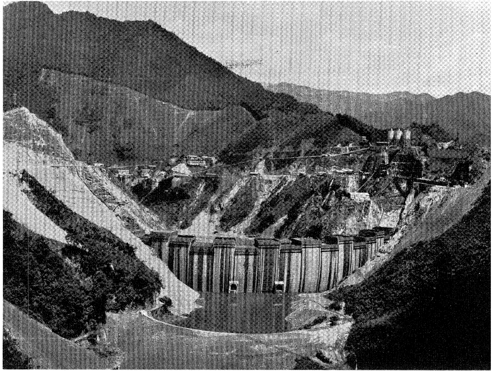
〔写真右・たち上り中の池原ダム 写真上・建設中の発電所内部〕
