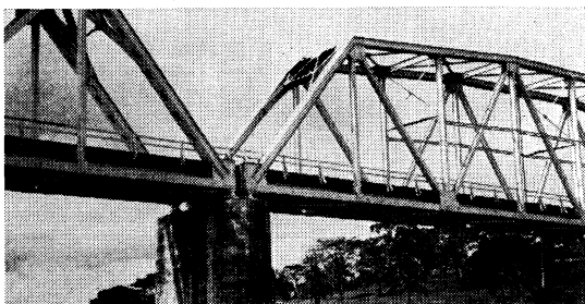
写真-8 Nare 河の鉄道橋
