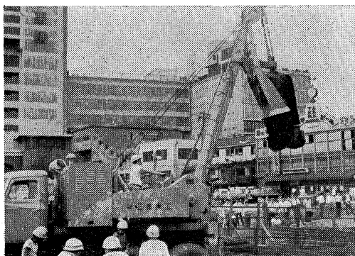
写真一 首都高速道路 3 号線渋谷駅前で作業中のベント ボーリング マシン
