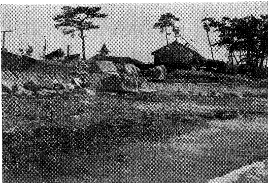
石積護岸被害状況および標準断面 (大阪府泉佐野市佐野漁港区域)
