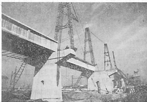
PS コンクリート桁(8本締め複線式) 支間 24.5 m、基礎井筒コンクリート φ5.5m
