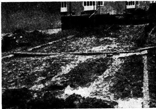
写真-5 降雨後の路盤(安定処理不能)
