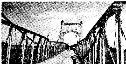
吊索の伸長に依り Truss の Topchord が曲折し橋床面が中央部に於て相當低下している
