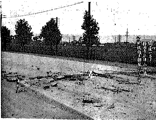
第 1 圖 コンクリート舗装の被害 (静岡市谷津山附近國道 1 號)
