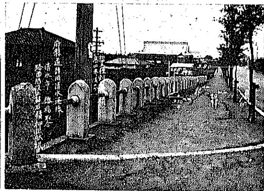
第 2 圖 路面陥没土留石積押出状況 (清水市櫻橋取合)
