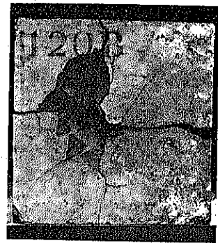
第 24. No. 120 Bの表面破壊状況
