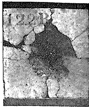
第 30. No. 122 Bの裏面破壊状況
