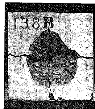
第 69. No. 138 B の裏面破壊状況
