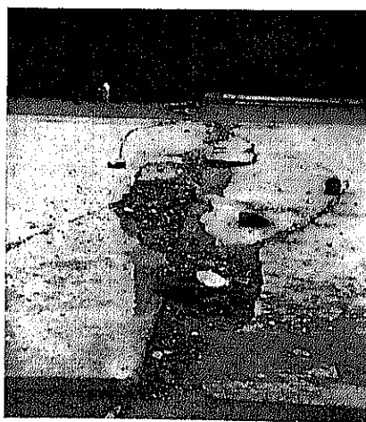
(33) 静岡国道コンクリート舗装破壊状況
