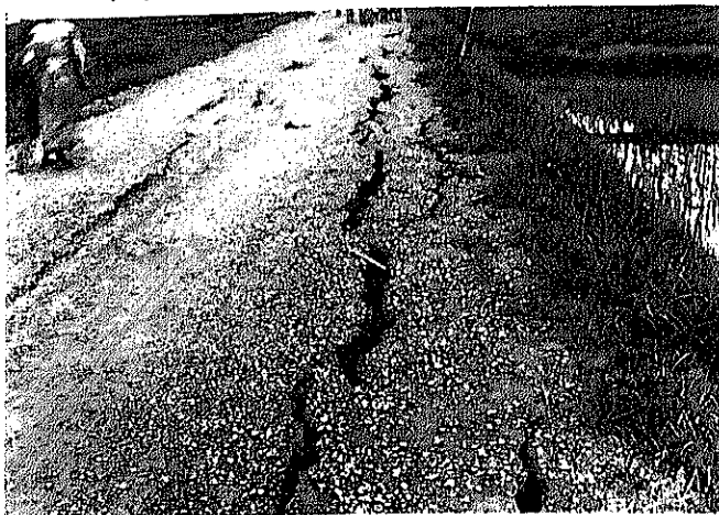
(30) 府縣道静岡・久能線の龜裂 (静岡市大谷地内)
