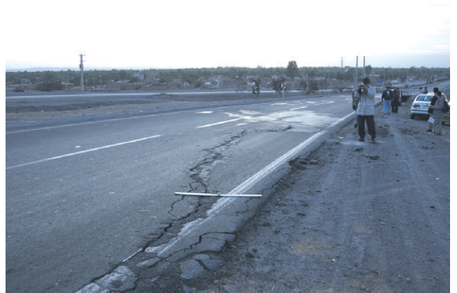
写真-2 撓曲崖を横切る道路の亀裂
