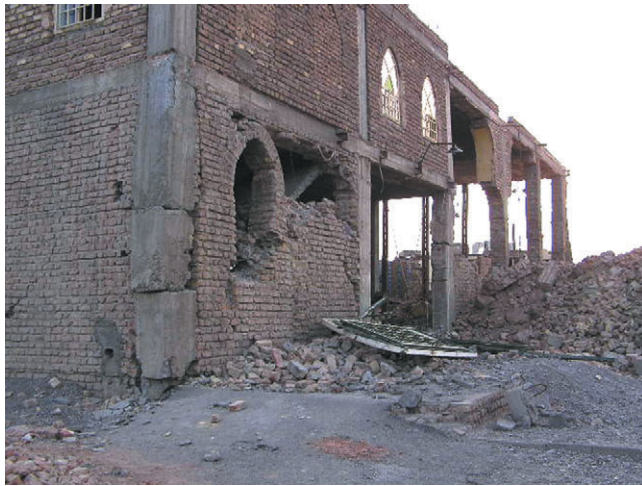
写真-4 モスクの被害状況
