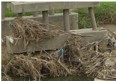
図-1 橋脚付近で捕捉された流木群
