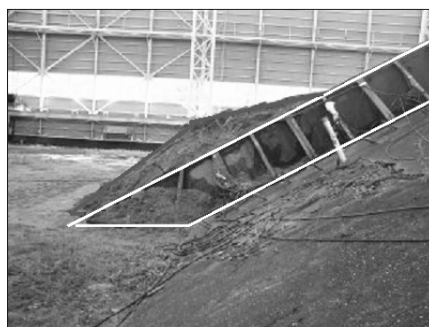
写真-4 崩壊後の様子
