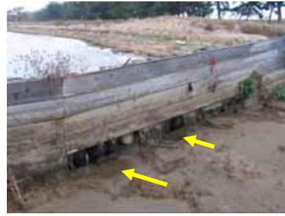
図-13 2号突堤の破損状況（2007年11月22日撮影）
