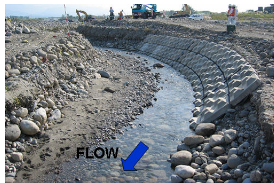
(b) 護岸付近の深掘れ
