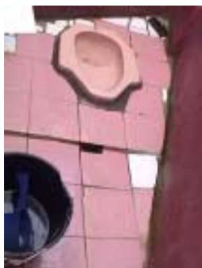
写真-1 家庭用トイレ
