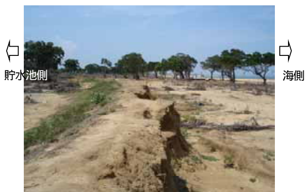
写真-6 道路の破壊状況
