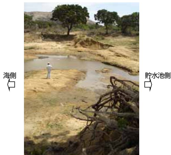
写真-5 道路の破壊状況
