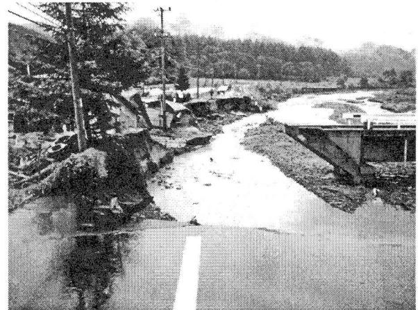
図-4 貫気別川河岸浸食による道路の被災(北海道提供)
