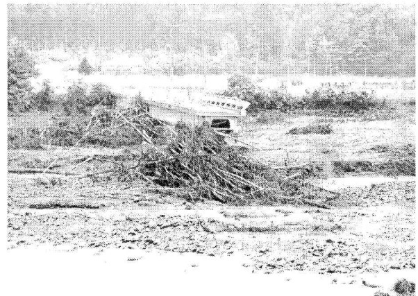
図-10 アブシトエナイ橋の被災状況
