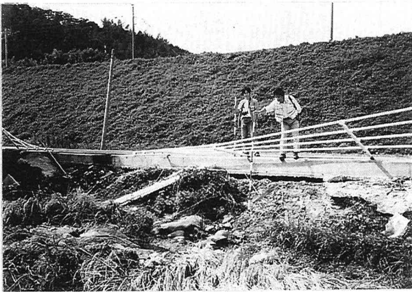
写真 -10 洪水により倒された柵とその手前側に形成された洗掘
