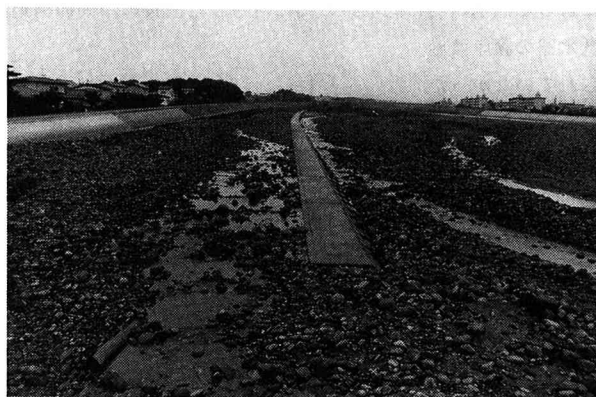
写真-2 低水路護岸された高水敷の侵食例
