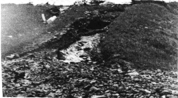
写真-2 越流による堤防坂路の浸食(同上)
