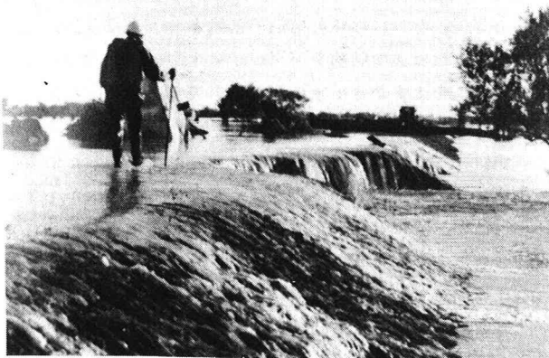
写真-1 越流による法面崩壊(北海道開発局提供)
