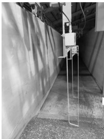
図－6 容量式波高計の設置例
