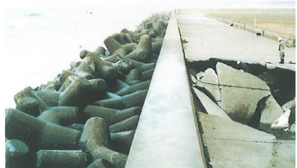
図-5.2 吸い出しによる護岸背後地盤の陥没事例
