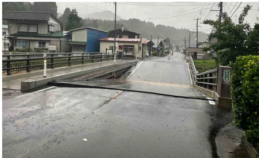
図-15 8月10日午前5時頃の小赤川橋の様子（撮影：青森県）
