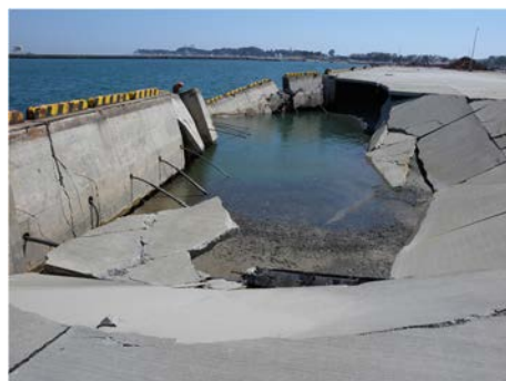
図-8 岸壁の被害例
