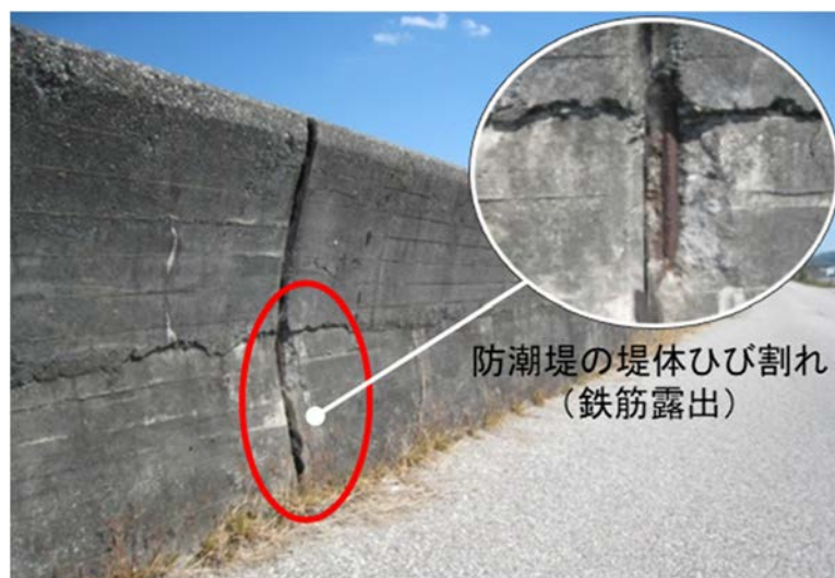
写真－２ 高知港海岸防潮堤の劣化状況
