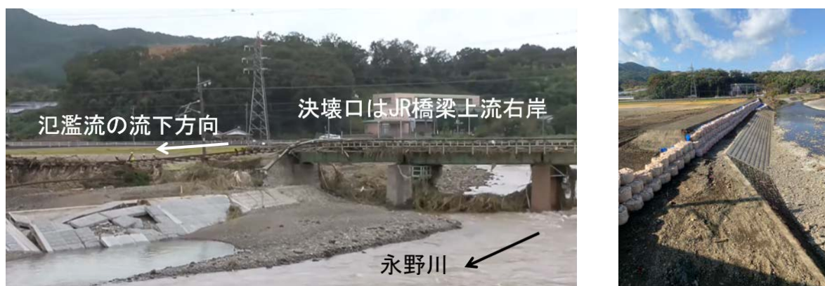
図26 栃木市大平町川連地点右岸の堤防決壊口（右）およびJR橋梁を下流側から上流に向かって見た状況（決壊口は左図JR橋梁の右岸にある。JR橋梁上部に残存する多くの流下物が見られる）
