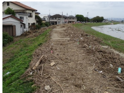
図22 秋山川破堤地点上流側の右岸堤防に残 存する流下物（越水氾濫の様子が分かる）
