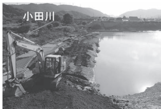
図 3.7 小田川 3.4 km 左岸の堤防決壊状況
