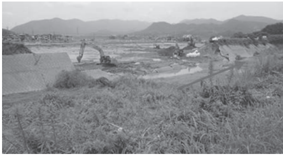
図 3.18 真谷川 0.5 km 左岸の決壊状況
