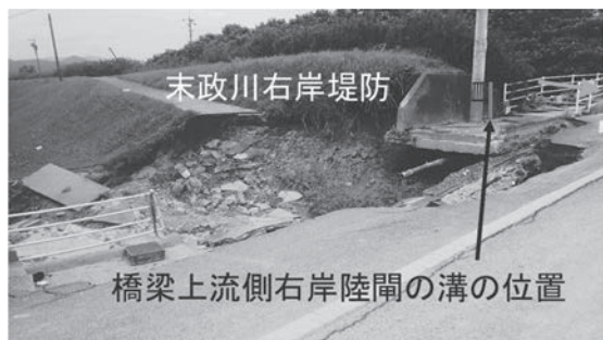
図 3.14 末政川 0.4 km 付近の被災状況と陸閘
