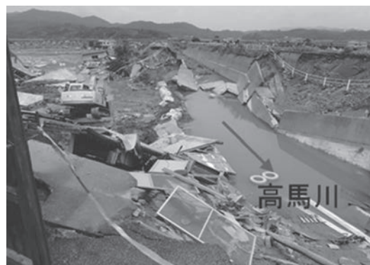
図 3.8 高馬川右岸の堤防決壊状況
