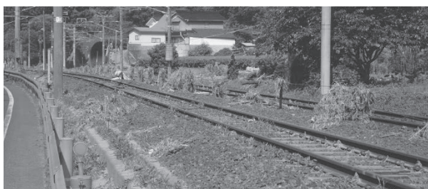
図 4.10 日羽と美袋間の伯備線の浸水状況
