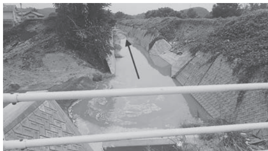
図 3.13 末政川 0.4 km 付近の兩岸決壊箇所の状況
