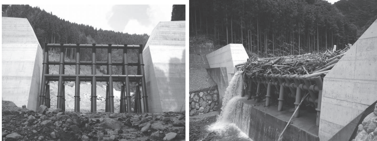
図-6 透過型堰堤の設置例（右は流木の捕捉状況）
