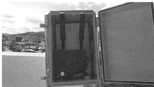
図-5 あめにわ憩いセンターの屋上に設置したSORACOMの屋内用ゲートウェイ
