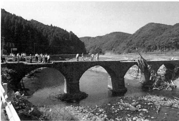
写真-2.1 星野川宮ヶ原橋の流木被災
