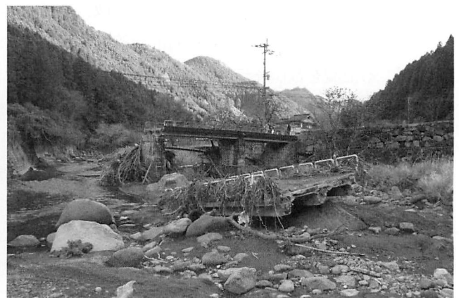
写真-2.4 高瀬川の橋梁の流木被災
