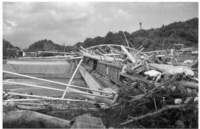
写真-2.2 玉来川阿蔵新橋の流木被災
