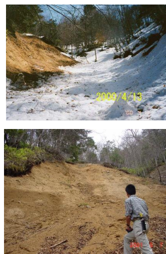
写真ー1 凍結融解により生産された土砂が積雪の残る斜面下部に堆積した状況
