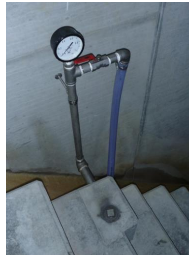
図-10 基礎排水孔と揚圧力計 3)
