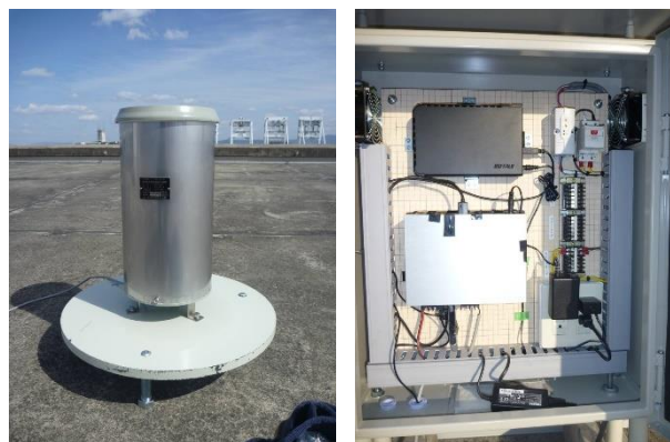
写真 4 雨量計および雨量データ配信システム
