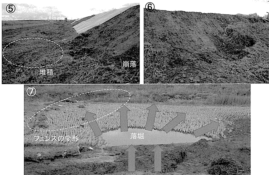
写真5 決壊地点B堤内側の状況
