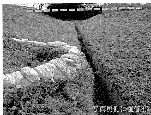
図10 裏のり面の冠水状況 (38.17k 右岸)
