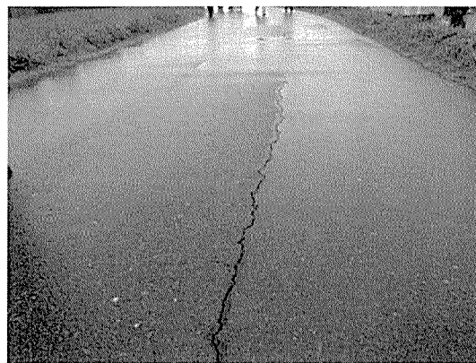
図4 エアブロー発生地点（鬼怒川 7.75k 左岸）
