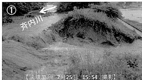
写真-13 堤防決壊箇所の状況
