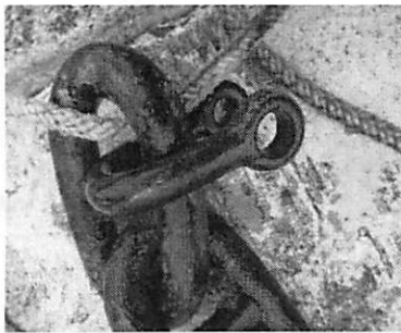
ピンの外れたシャックルの様子
