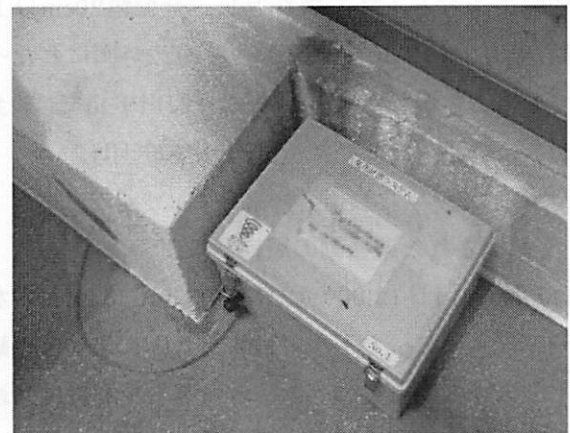
チューブが引っ張り出され、蓋の留め具が はずれていた様子
