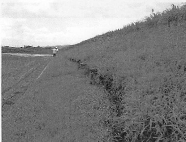
写真-10 矢部川 11k 800 付近川裏法尻陥没状況
