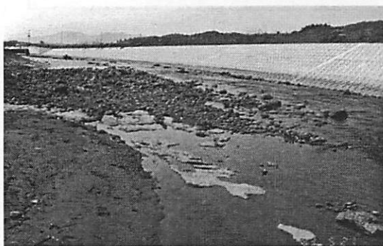
写真-1 河床低下による護岸被災
