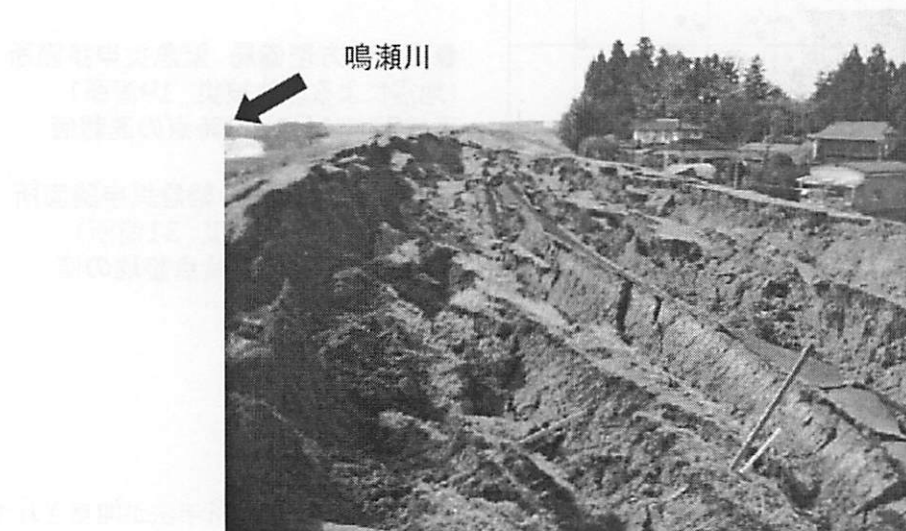
図-5.5 堤体の液状化と推定される堤防の被災状況 (鳴瀬川 左岸 30.0k 付近(下中ノ目上流地区))
