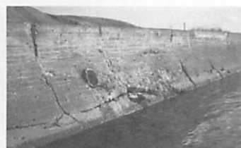
堤防の表法被覆工が損傷
