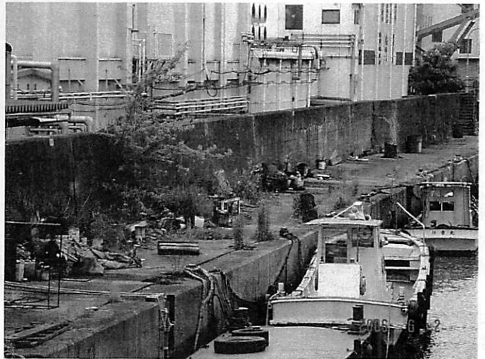
写真-5 老朽化した防潮堤
